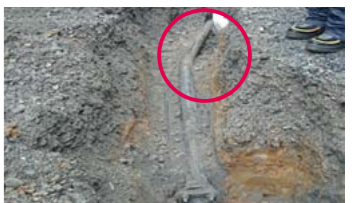
▲地震で折れた水道管 (2014年11月、長野県神城断層地震)
